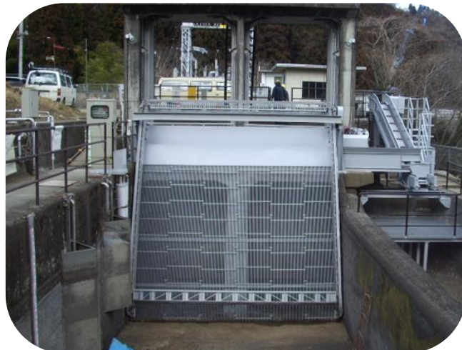
水力発電所水槽 ロータリーチェーン式自動除塵機
