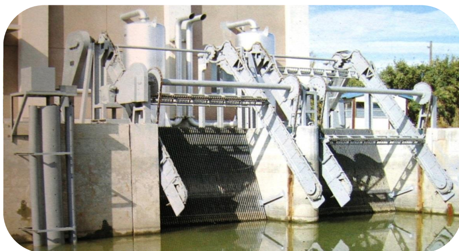
農業用排水機場 ロータリーチェーン式自動除塵機 (2軸2連式)
